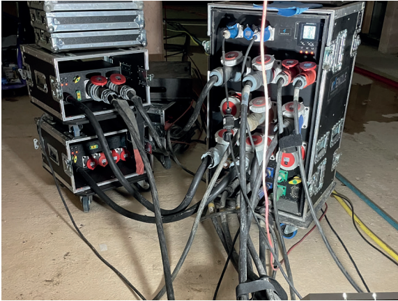
Tokovni razdelilniki in merilne transformatorske omare do 600 A
